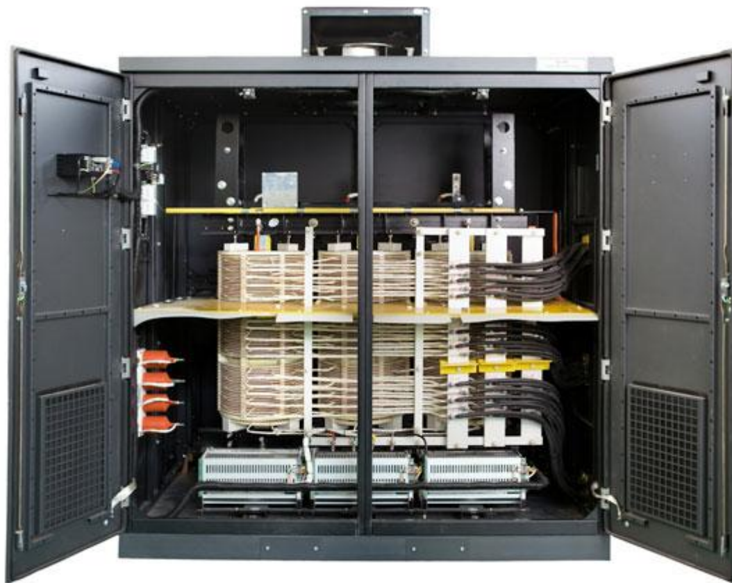
Рис. 10 Шкаф трансформатора ВПЧА
